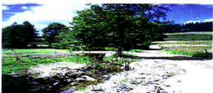
A La Naute, Le Trifoulou coulait dans un chemin : des travaux l'ont réinstallé dans son lit.
